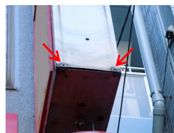
ビスが欠落し、側板が外れかかった状態
