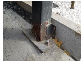
支柱根元の腐食が進行した状態
