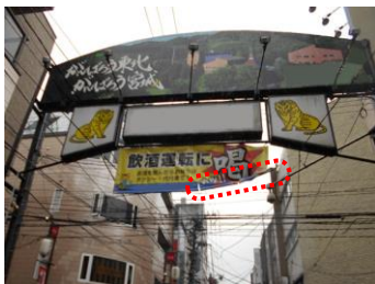
幕材を張る部材が破損した状態
