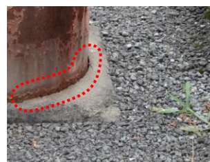
根巻きと支柱との隙間があり、さびが進行した状態
