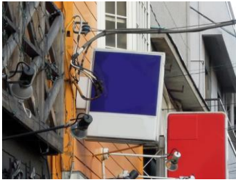
屋外広告物本体の傾き
