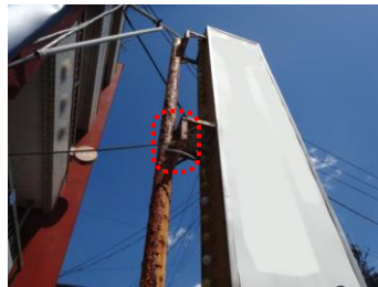
支柱・広告板接合部の腐食・隙間
