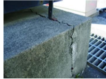
基礎にクラックが入った状態
