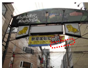
幕材を張る部材が破損した 状態
