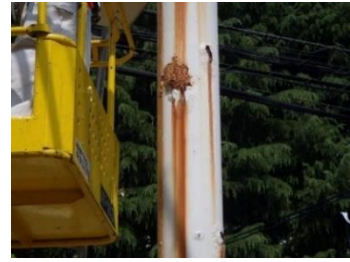
その他（支柱の腐食など）
