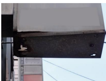
側板底面が腐食、破損、変形した状態
