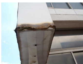
側板の腐食が進行した状態
