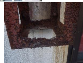
支持部が腐食していた看板の例
