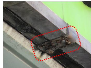
金具が劣化した状態
