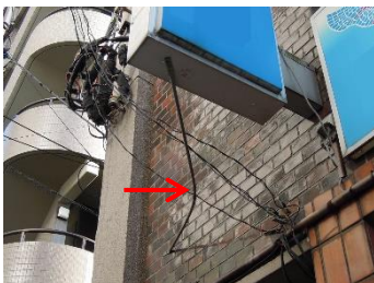
振れ止め棒が変形した状態
