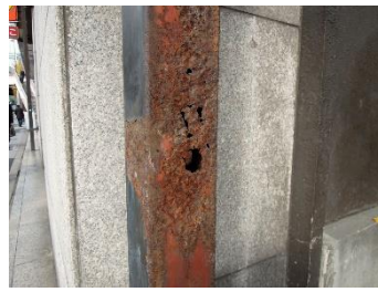
支柱の腐食が進行した状態
