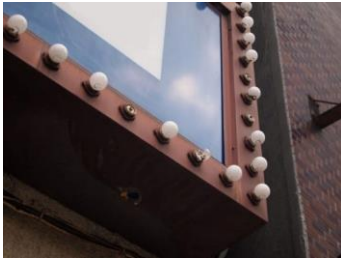
ランプ球が破損した状態
