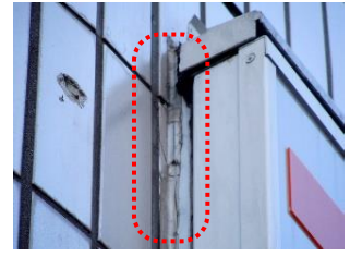
コーキングが劣化した状態
