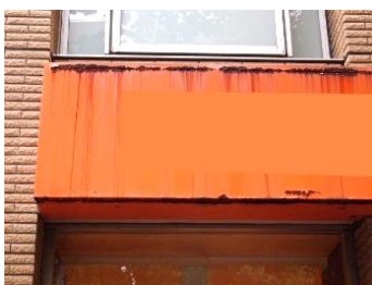
側板の腐食が進行した状態
