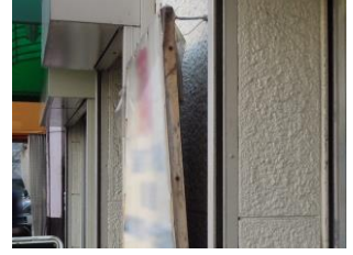
壁面との間に隙間が生じた状態
